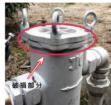
凍結により破損した給水装置
