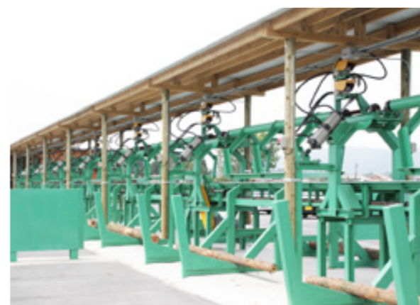
新設された選別機
