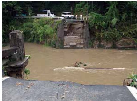
松山地区では橋が崩壊しました
