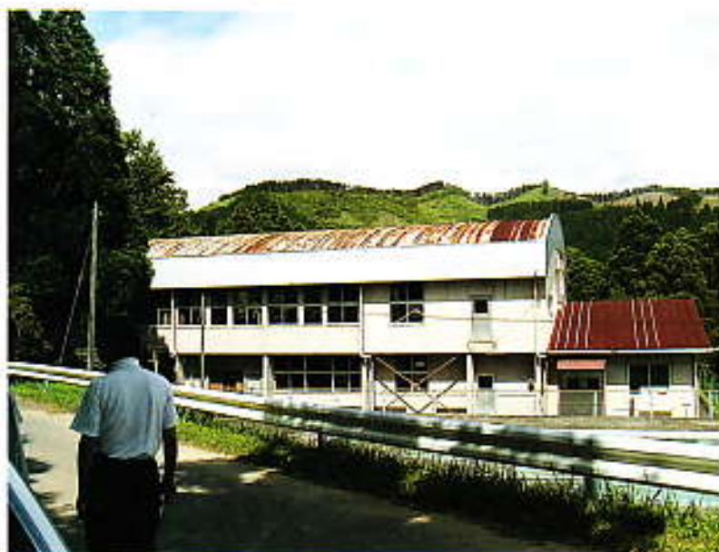
老朽化が進む八野小学校体育館
