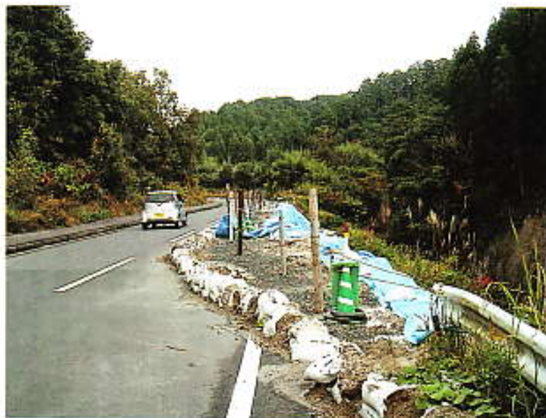
集中豪雨による被害状況
