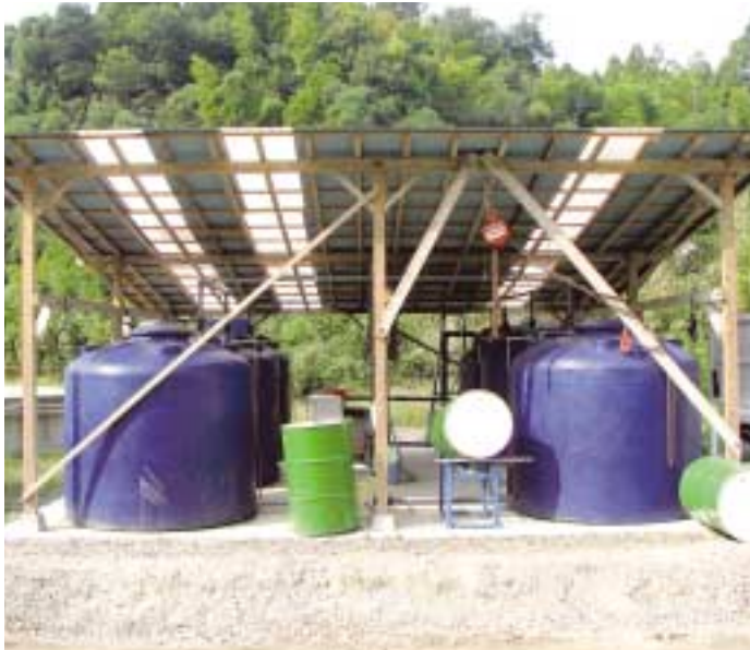
グルンパシステムの設備
