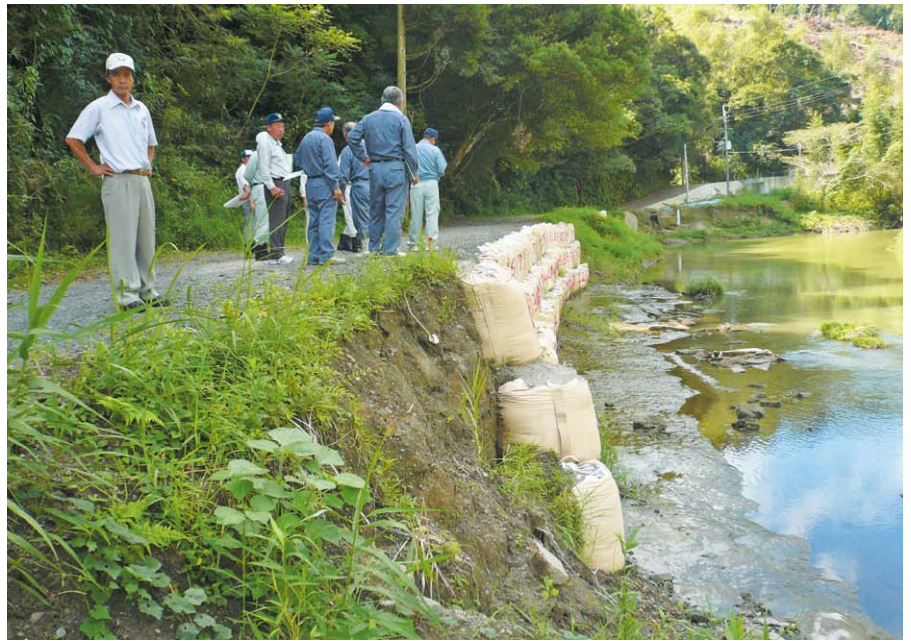
市道芝用水源地線の災害状況を調査する委員
