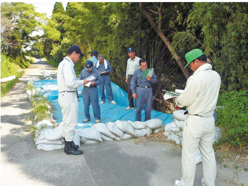
市道岩屋・芝用1号線の災害状況の説明を受ける委員
