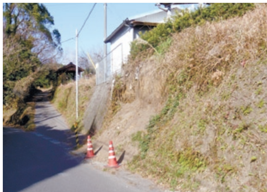
宅地災害の状況
