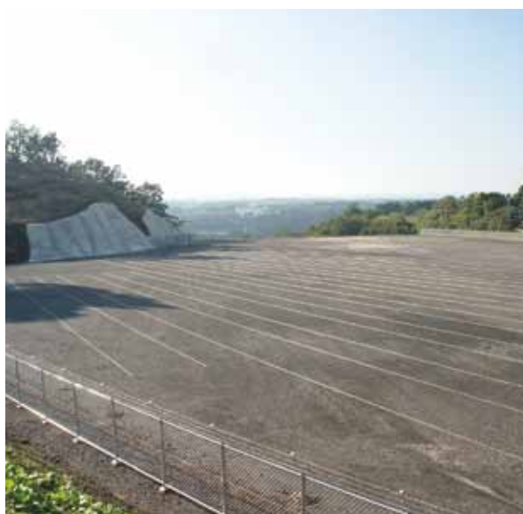
建設中のメガソーラー
