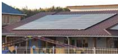
保育園に設置されているソーラーシステム
