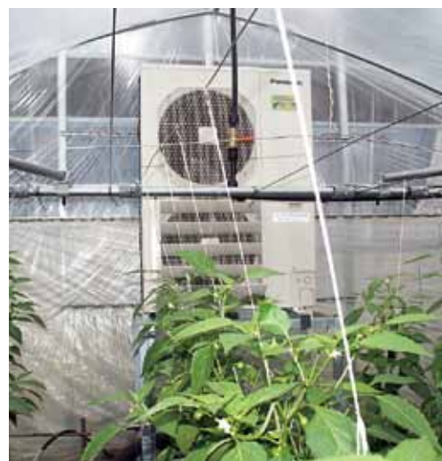
ヒートポンプ
