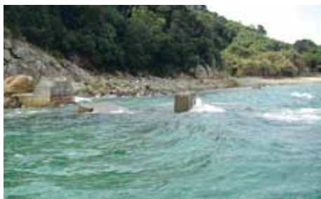
破損している枇榔島の栈橋
