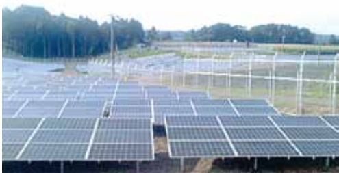
造成しないで設置されたメガソーラー
