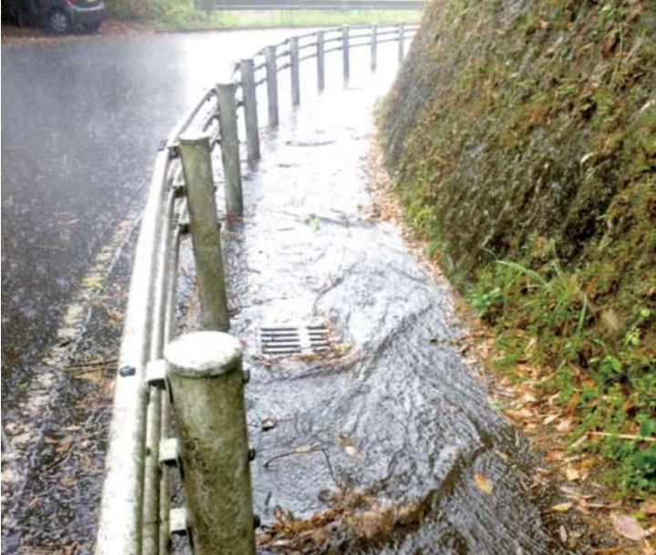
雨天時の市道上松馬場線の歩道
