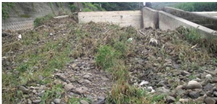
被災した岩戸堰
