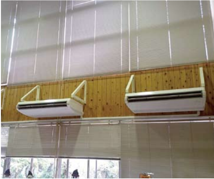
蓬原小学校図書室に設置してあるエアコン
