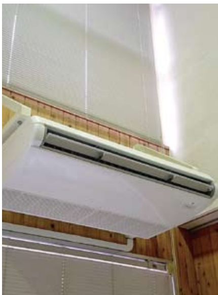
特別教室に設置してあるエアコン
