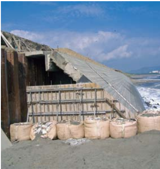
高波により決壊した堤防
