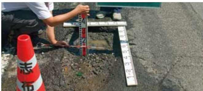
市道陥没現場
