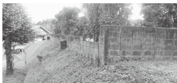
小学校ブロック塀危険箇所
