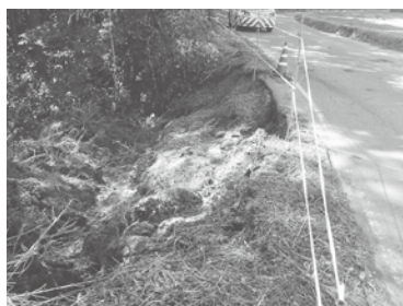
災害による危険箇所
