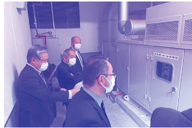
ホルベリアダグリ自家発電機の現地確認
