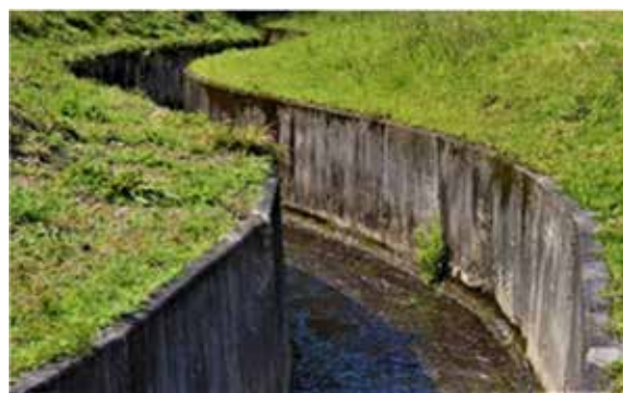
護岸のコンクリート化で生物の生息地が失われてしまった河川。三面護岸化が数多く見受けられる
