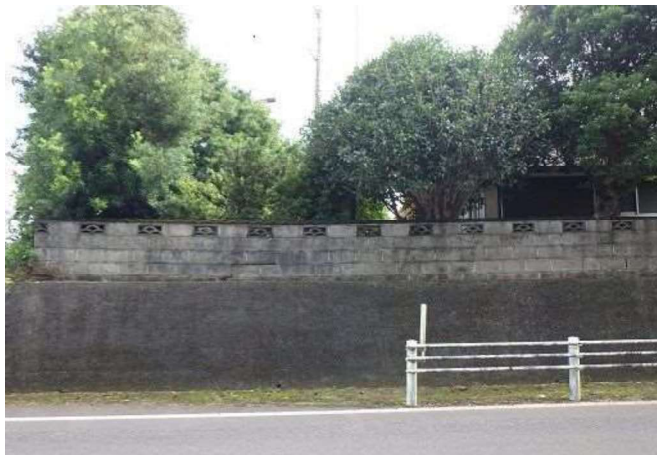
対象となるブロック塀
