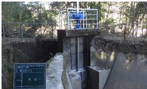
更新された取水ゲート
