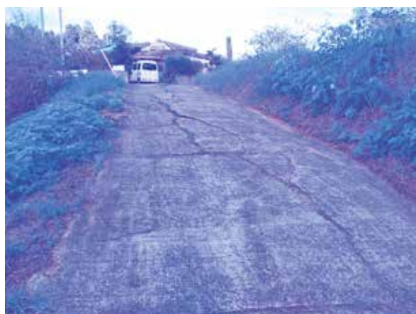
ひび割れ等一日も早い道路補修を望む生活道
