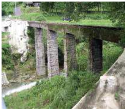
写真上：旧井久保橋（二連アーチ橋） 写真下：牧野開田新田山架け越し水路橋（桁橋）
